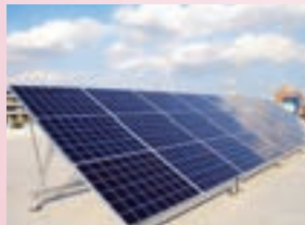
太陽光発電システム
